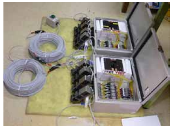
図5 試作したコントローラの内部
