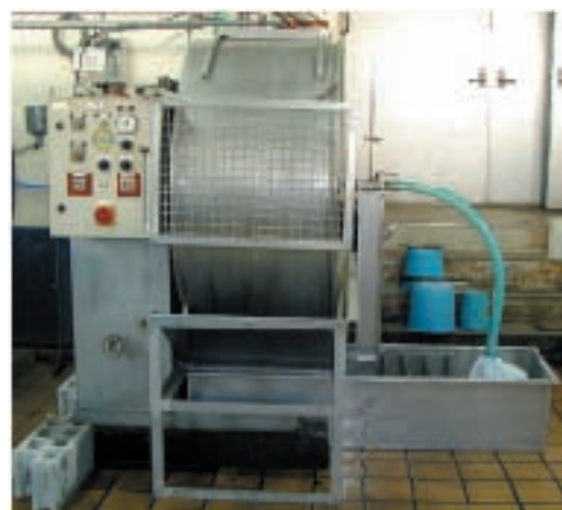
図1 石灰浴液の循環装置
