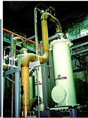
海水電解式次亜塩素酸ナトリウム注入装置
