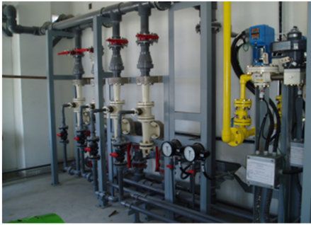
塩素ガス注入装置
